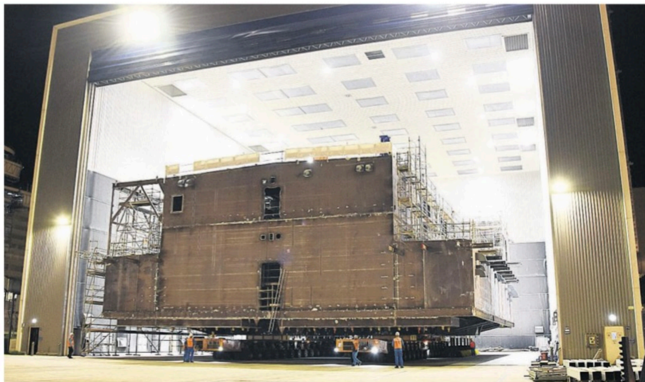
La sous-station électrique, avant la phase de peinture et d'équipement.
